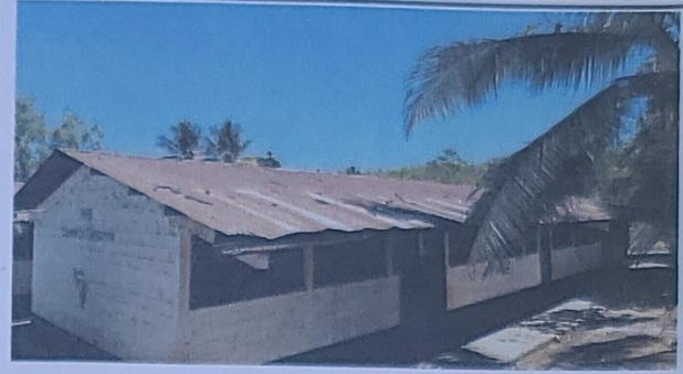
Foto 2: Deterioro del techo en su totalidad del Modulo 2
