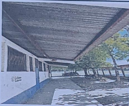
Foto 3: Se observa en oxidado y deterioro de costaneras en el corredor del modulo 2
