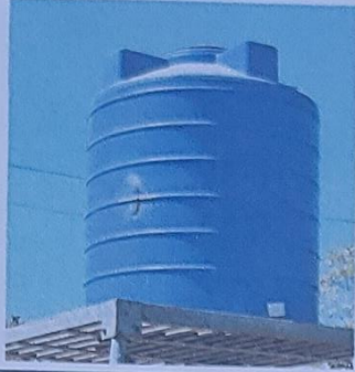
Foto1: Deterioro del tinaco a un costado.
