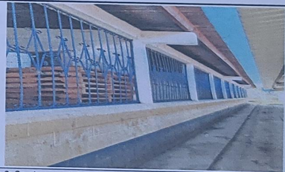
Foto 6: Se observa el deterioro de pintura del modulo 1
